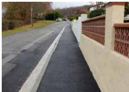
5 Rue des Genêts : réfection du trottoir du côté des numéros pairs de la voie
