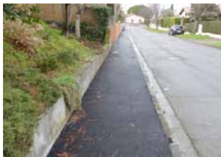
4 Rue de la Tour : réfection des trottoirs du côté des numéros pairs de la voie.
