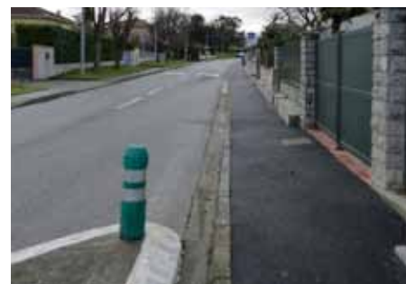
8 Avenue Augustin Labouilhe (section place Augustin Labouilhe / avenue de la Marqueille) : réfection et élargissement des trottoirs du côté des numéros pairs de la voie.
