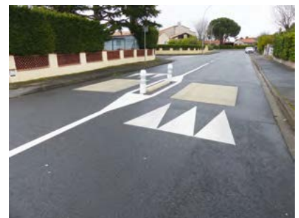
Exemples de chicanes et coussins berlinois installés avenue de Labouilhe et rue des Améthystes.
