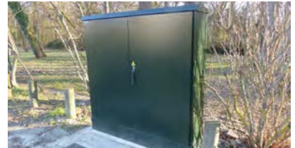
L'une des 19 armoires installées dans la commune.
